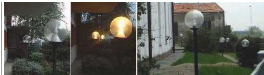
Fig.19 – Nelle 2 foto di sinistra l'illuminazione è conforme alla deroga con 3 punti luce non schermati di max 23W a fluorescenza. Nella foto di sinistra però la deroga è applicabile solo se i 5 apparecchi (punti luce) fossero dotati ciascuno di lampade di max 23W a fluorescenza schermate verso l'alto (cosa che non avviene) in modo tale che l'emissione massima oltre i 90° non superi complessivamente 2250lumen.
